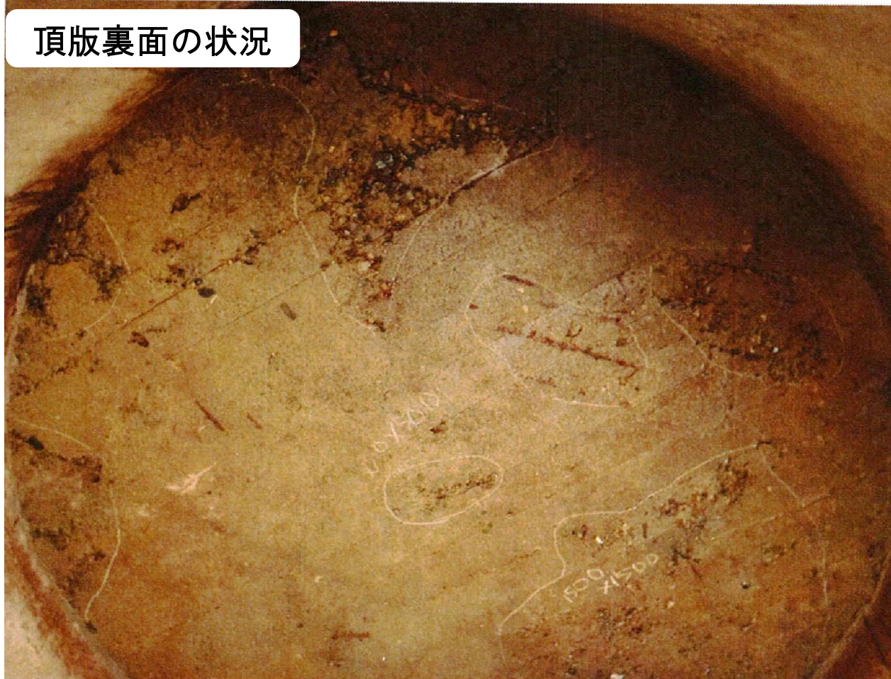
頂版裏面の状況
